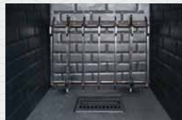
Camera di combustione. Griglia sollevata
